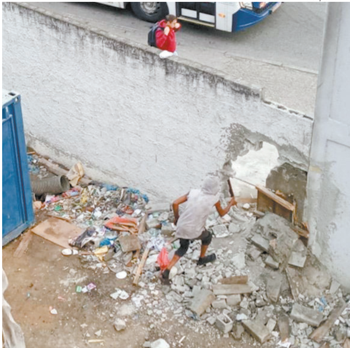
Homem foi flagrado por câmera passando por abertura feita em muro perto da estação Maracanã
