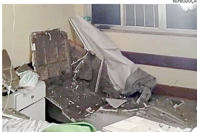
Fixação de um blackout teria danificado a estrutura de gesso
