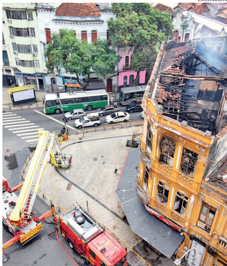
Bombeiros voltaram a trabalhar em prédio que pegou fogo
